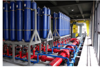
蓄能器组及高压管路
